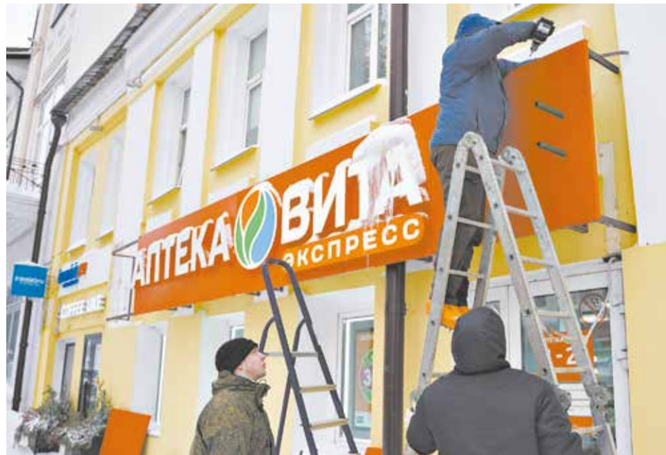
Вывеска на ул. Московской, 7 не соответствовала требованиям.
